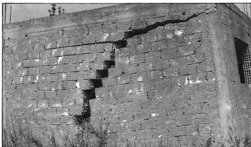
Fot. 4 — Casa em construção, destruída por movimento de terras na vertente W do vale do ribeiro da Ossa.
