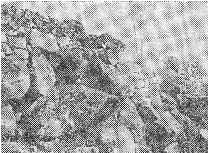
Fig. 4 — Trabalhos de reconstrução da 2. a muralha (troço 3 da fig. 2). Na sua construção foram aproveitados grandes blocos graníticos nas suas posições naturais.
